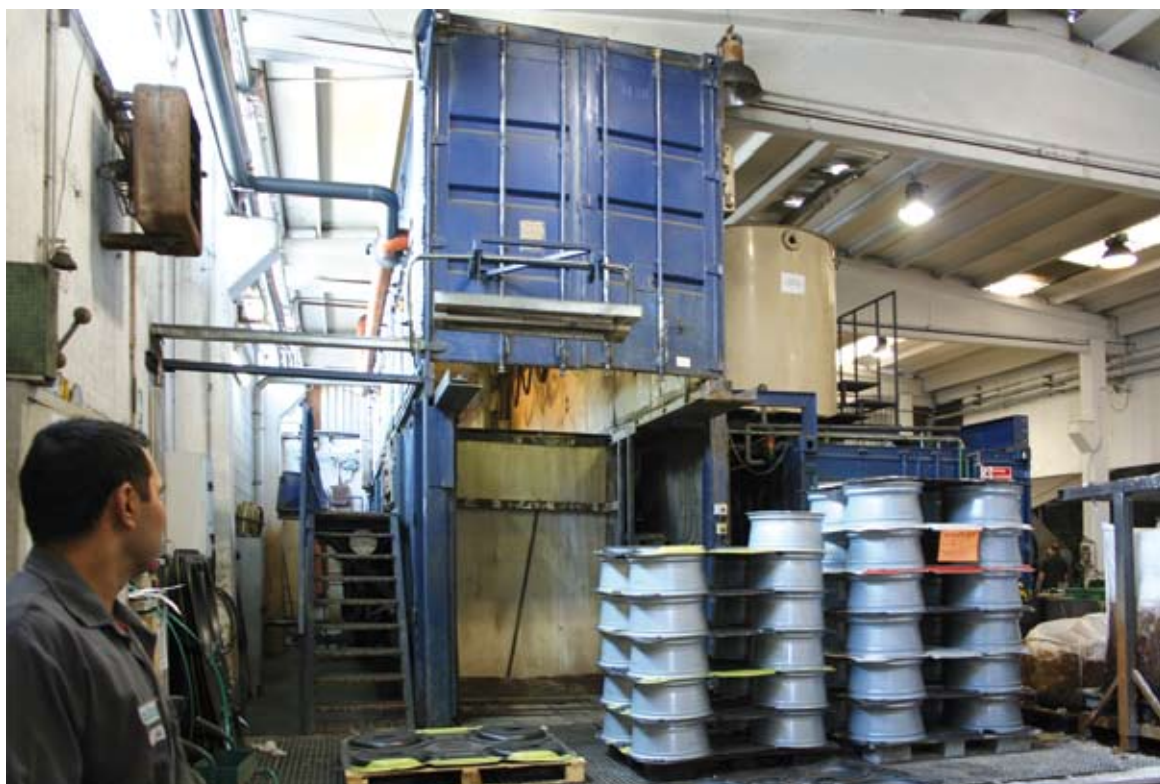
6 - Vista generale dell'impianto di sverniciatura chimica di ruote.
